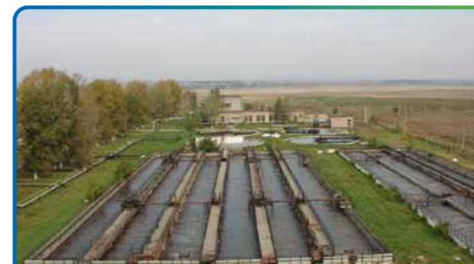
Аэротенк, Водоканал, г. Челябинск
